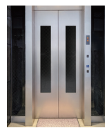
エレベーター
